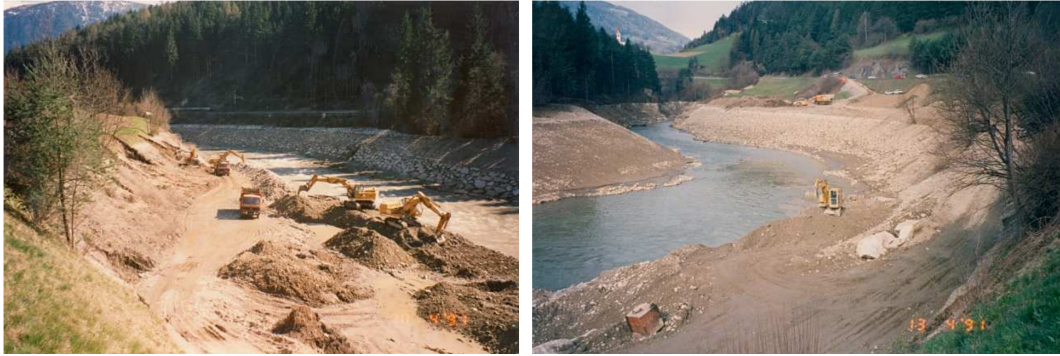
Figura 6.5: I lavori di stabilizzazione delle sponde del bacino di rigurgito nel 1991 (fonte: Azienda Servizi Municipalizzati di Brunico)
